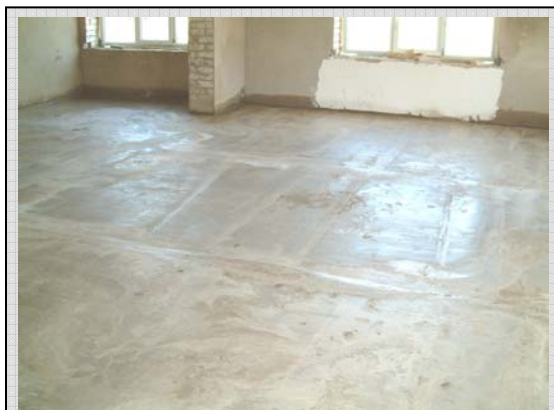
Затвердевший пенобетон теплозвукоизоляционного слоя
