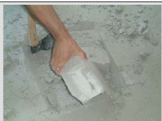
Хорошее сцепление пенобетона с железобетонной плитой создает трудности отбора проб
